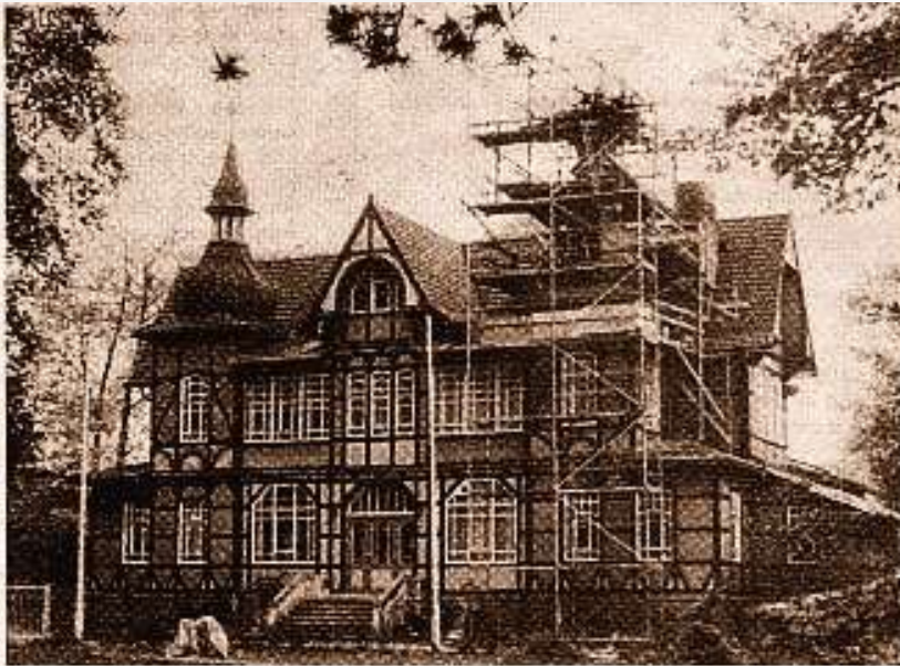
Werterhaltungsarbeiten wurden am Objekt des Inhalatoriums in Bad Sulza durchgeführt. Das Gebäude im Kurpark erhielt einen neuen Fassadendachstuhl. Gegenwärtig werden die Türme neu eingedeckt. Diese Maßnahme gehört zu den zahlreichen Vorhaben, die der weiteren Verbesserung des Niveaus des Kurbetriebes dienen. Foto: VK Walter Marx
